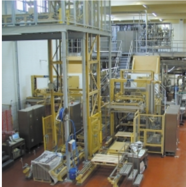
Foto R.1.4. Becherfüllmaschine und Versorgung mit Leerpaletten via Noell-Senkrechtförderer. Die Paletten werden von Flurförderzeugen abgeholt.
